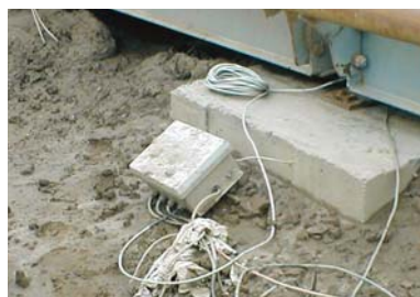
取消接线盒后，消除了衡器的一个常见故障源。
